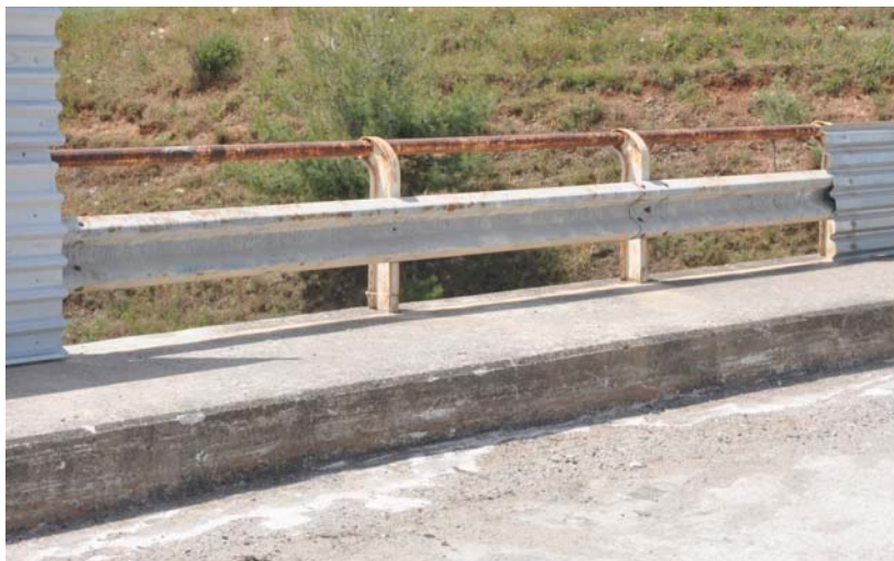
Σχ. 16 Υφιστάμενο στηθαίο ασφαλείας (προς αντικατάσταση).
