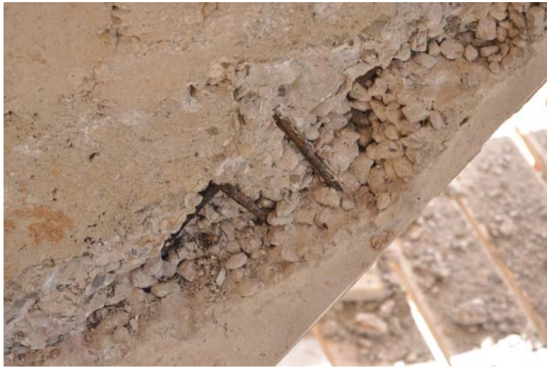
Σχ. 4 Απόμιξη σκυροδέματος σε στύλο μεσοβάθρου.
